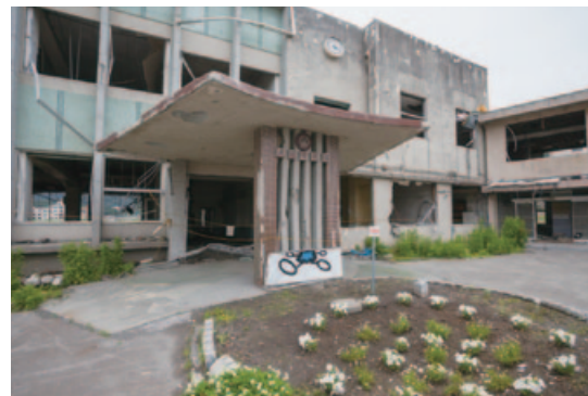
被害を受けた大槌町役場
